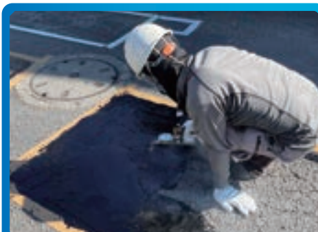
⑤ 敷均し工 マスチックワンを専用コテで敷均しする
