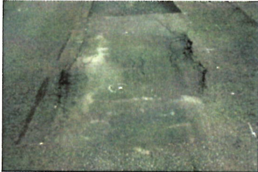
写真-12 L, M工区境界部での局所的側方流動 (累積 60 万輪)
