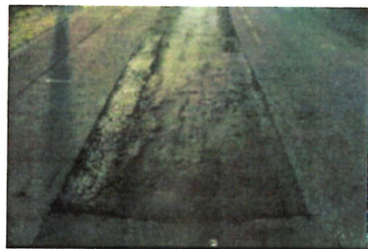
写真-11 N工区(施工後夏季の12日間に約4万輪走行後)
