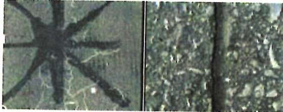
写真5 舗装のひび割れ例 (30万輪後) (シーラ工法) 写真6 シーラ材のひび割れ例 (30万輪後) (シーラ工法)
