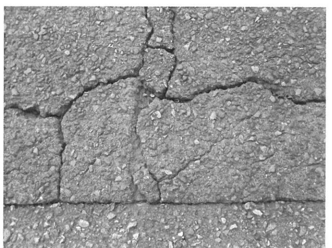
5年後の様子 (7.7mm にひび割れが拡大)
