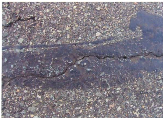
写真-15 写真-14の拡大 施工後、乳剤がクラックに浸透して再度クラックが見えている。
