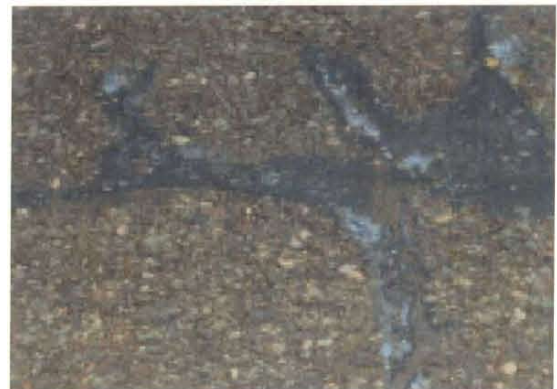
写真-18 写真-17の拡大 クラック部への浸透良好で、剥離がない。
