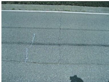
舗装のひび割れ現状
