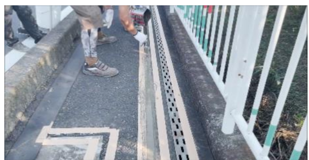
④MK もるもるを充填 MK もるもる 10Kg/袋に対し 3.5 リットルから 4 リットル水をいれ充填し、ヘラで敷き均す
